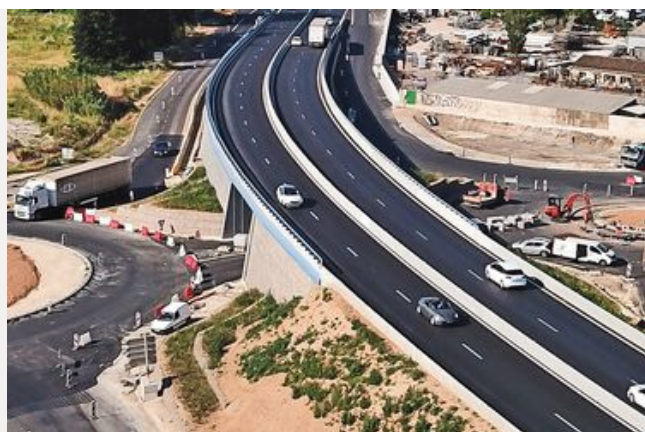
Travaux de dénivellation du carrefour giratoire de raccordement à la déviation Ouest de Montoux
