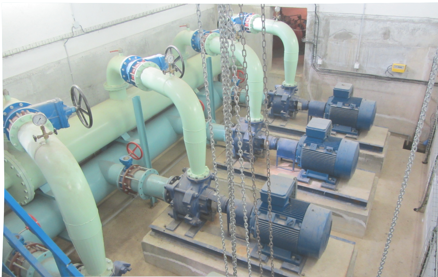
Station de pompage de Peyreras à l'Isle-sur-la-Sorgue
