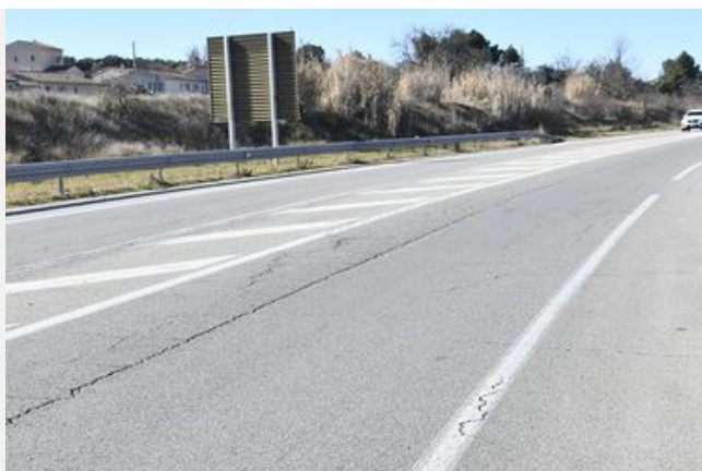
Renforcement de la couche de roulement sur la RD 900 entre le Pont Julien et Apt
