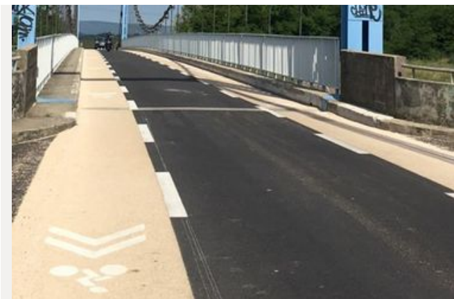
Aménagement d'un «chaucidou» à Mondragon sur la ViaRhôna (RD 44)
