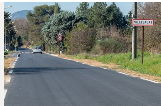
Mise en sécurité de la RD 37 entre le cours du Luberon et le pont sur le Marderic sur la commune de Villelaure
